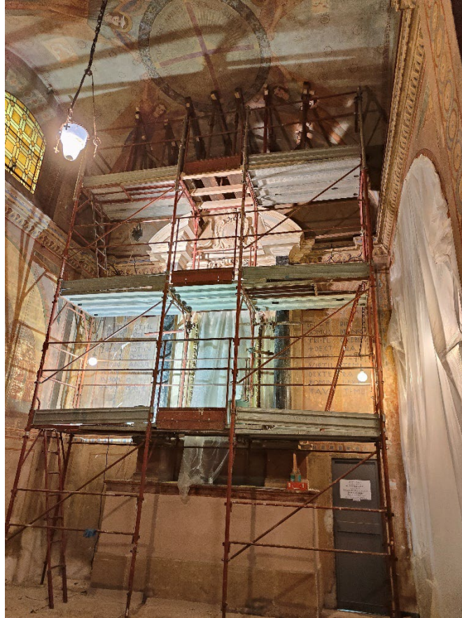
Documentazione fotografica puntellamento porzione di volta interessata dal cedimento
